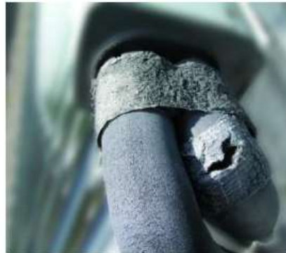
Falta de resistencia a los rayos UV
